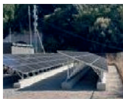
太陽光発電設備
